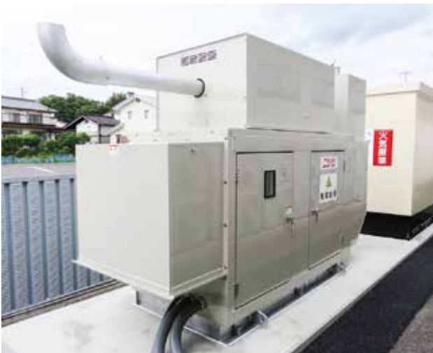
設置された非常用発電機。停電などで電力供給が止まると自動的に発電する。連続72時間、電気を送り続けられる。奥に見えるのが軽油タンク。
